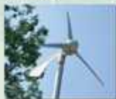
園内の照明に利用される風力発電も行っています。
